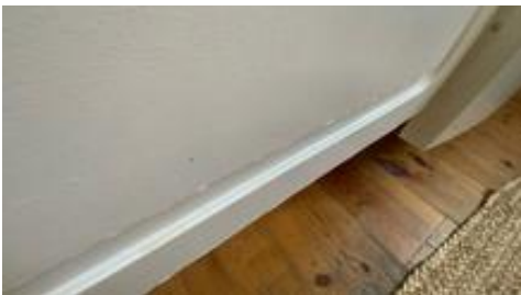
Fukt/kondenssvelling i nedkant av front.
