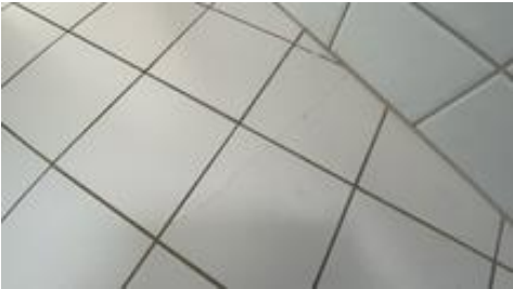
Det er sprekker i flere fliser.
