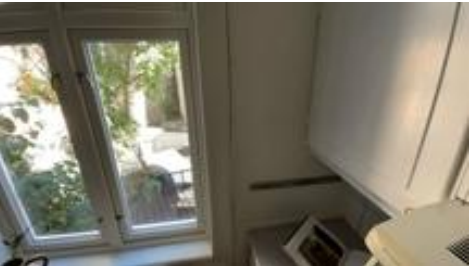
Løs kabel må festes.
