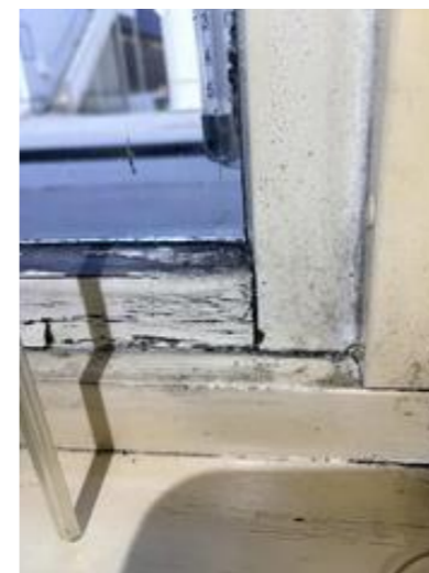
Eksempel på innvendig slitasje i kjeller pga. dårlig ventilasjon.
