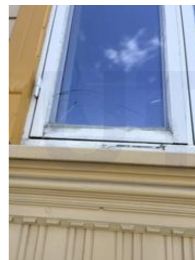
Eksempel på utvendig slitasje og knust vindusglass.
