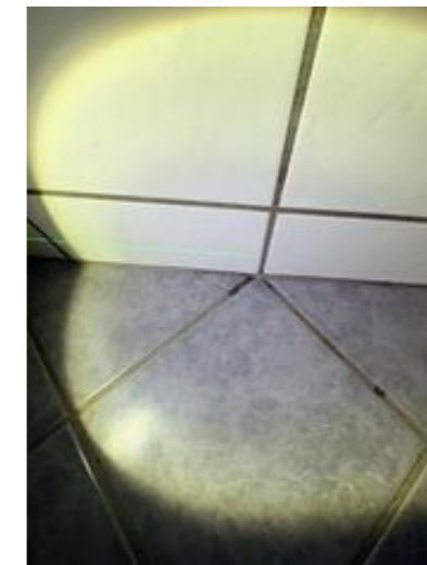
Sprukket gulvflis, med ukjent årsak.
