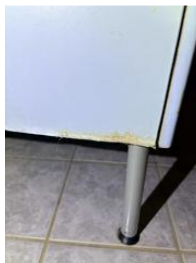
Det er fuktskader på nedre del av innredning.
