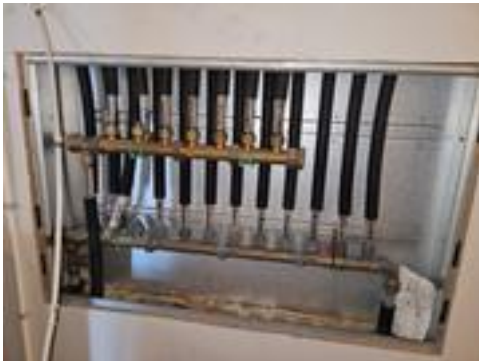
Fordelingsskap for tappevann
