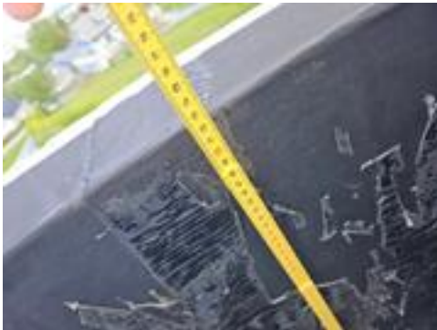
Rekkverket er for lavt
