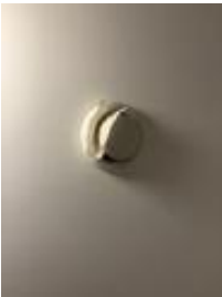
Bildet viser funksjonstest av avtrekket som er gjennomført med papir og vurdert som tilfredsstillende.
