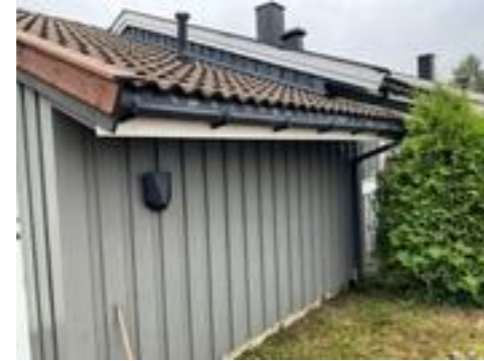
Bildet viser kledning for nær bakkenivå.
