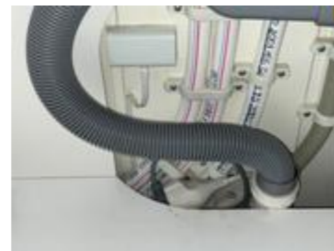
Skjøte ledning fastmontert i kjøkkenskap
