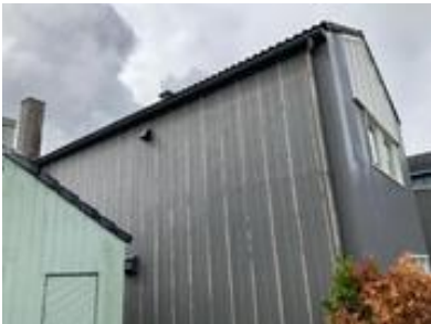
Pyntelekter er tatt vekk, ikke ferdigstilt eller malt/behandlet befaringsdagen.
