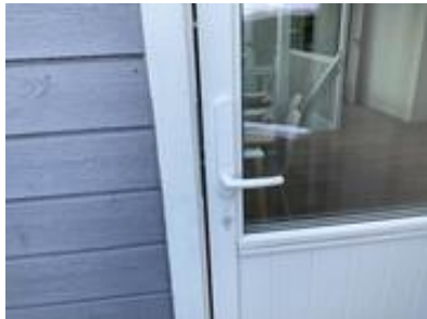
Større glippe mellom karm og dørblad.
