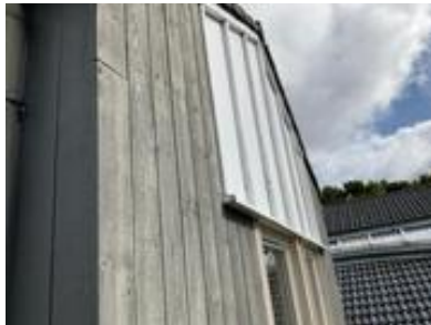
Magert behandlet bordkledning.
