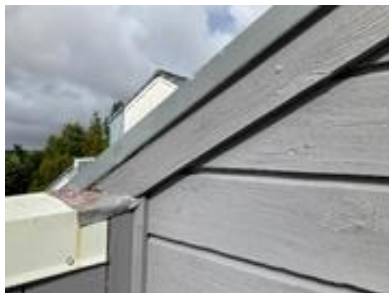
Værslitt bordkledning ved balkong.
