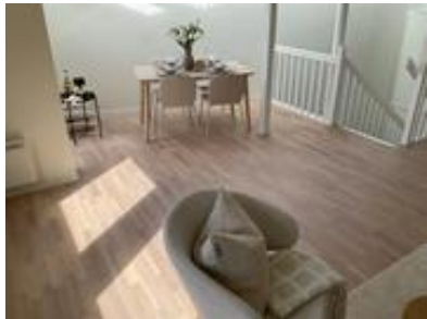
Større skjevheter på etasjeskillen i stue/kjøkken.
