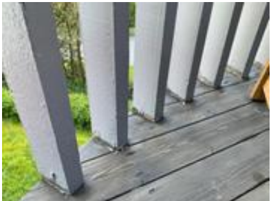
Malingsavflassing på rekkverk.
