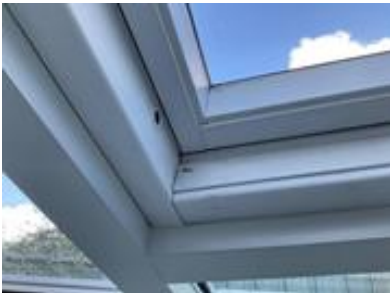
Fuktskader, oppsprikking/avflassing på glassrammer.
