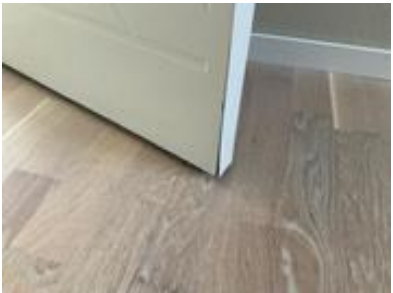
Skader på dørblad/laminat.
