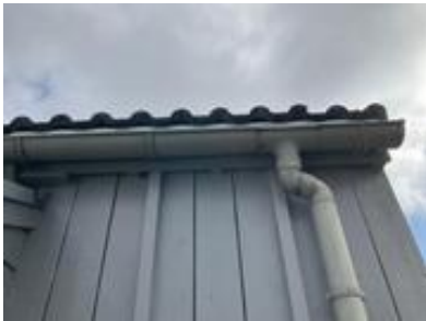
Lekkasjer fra renneskjøter/tappestykker.
