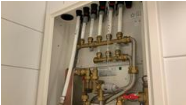
Vannledninger av plast.
