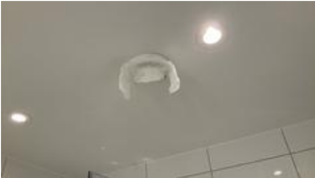
Avtrekk funksjonstestet med papir.
