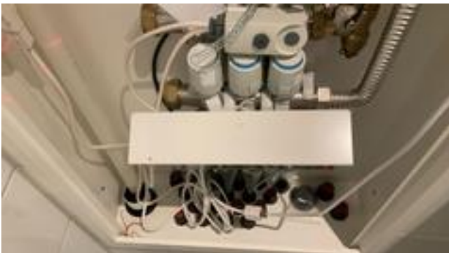
Kurser/motorer for vannbåren varme.
