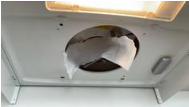
Avtrekk testet med papir.
