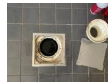
Sluket i dusjsonen
