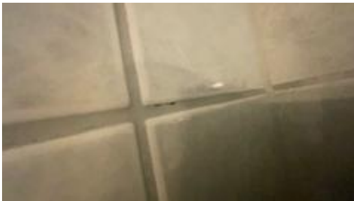
Småhull i fuger mellom fliser.
