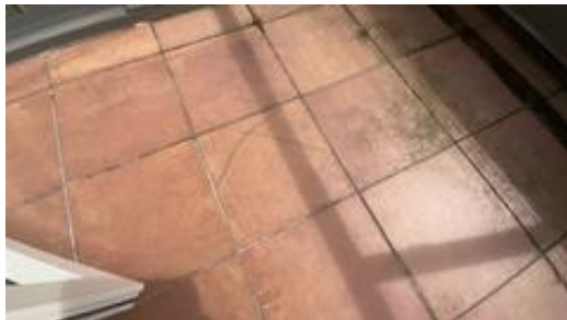
Sprukket flis på balkonggulv.
