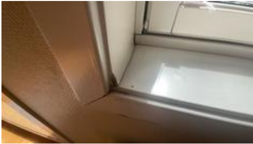
Fuktskader i foringer til lite vindu i soverom.
