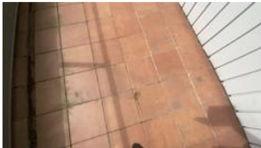
Sprukket flis på balkonggulv.
