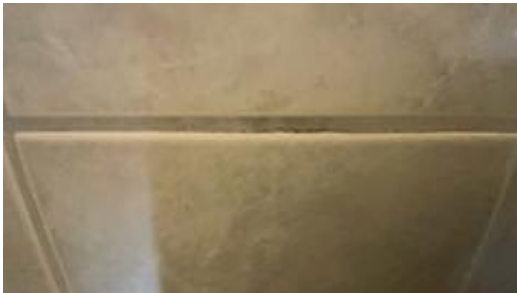
Småriss i fuger mellom fliser.
