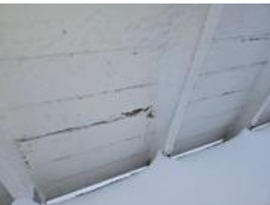
Noe råde på kledningsbord på rekkverket
