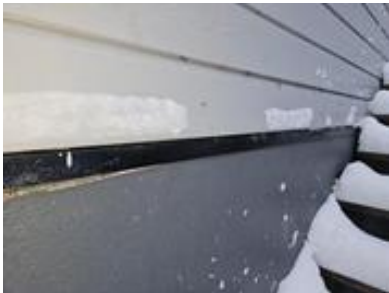
Lite lufting langs nedre kant av bordkledningen
