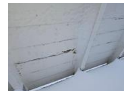
Noe råte på kledningsbord på rekkverket
