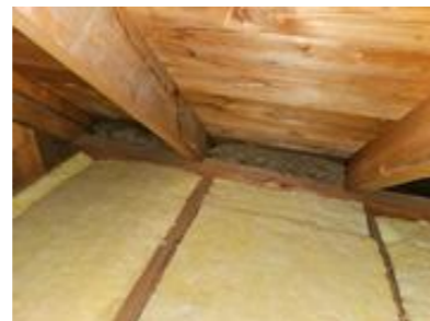
Isolert mellom undergurtene. Delvis isolerte skrå takflater, uten lufting.
