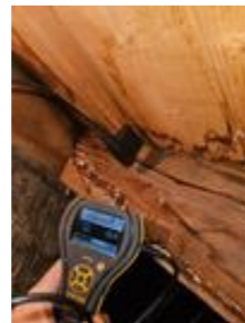
Noen gamle fuktmerker. Ingen tegn til fukt ved befaring.
