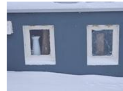
Vindu med enkle glass, fra byggeåret. Nærmer seg tid for utskifting.
