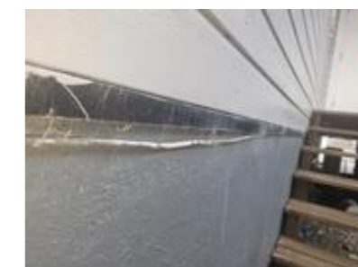
Lite eller ingen lufting langs nedre kant av bordkledningen
