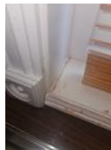
Fuktmerker ved utforingen under vinduet ved oppvaskkummen
