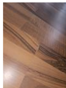
Noe slitasje på laminatgulvet i 1 etg
