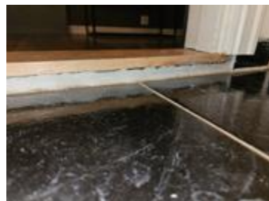
Det er laget en sokkel under dørstokken som ekstra sikring mot lekkasje
