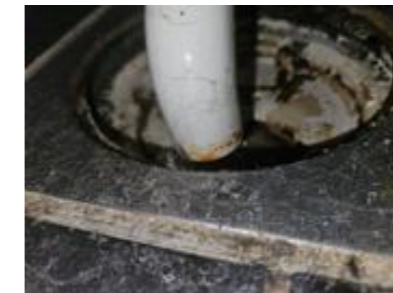
Spor av membran, men ikke mulig å se slukmansjett i sluken
