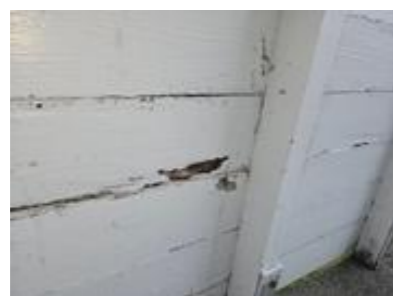
Litt råteskadet kledning på rekkverket
