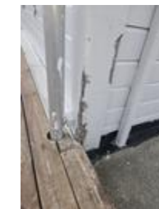
Slitasje, begynnende råte, ved hjørnet
