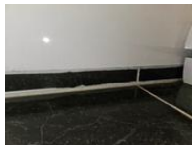
Ikke metallprofil mellom veggplatene og sokkelflis
