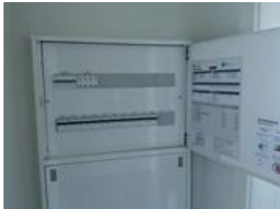
Sikringskap med automatsikringer og kursfortegnelse
