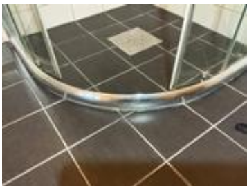
Fysisk hindring mellom sluk og gulv utenfor dusjsone.
