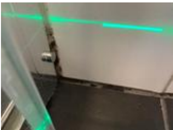
Sopp/misfarging silikonfuger i dusj.
