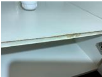
Svelling på innredning.
