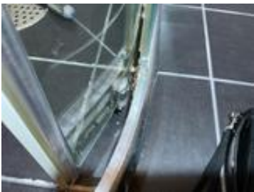
Mangler trinser på dør i dusj.
