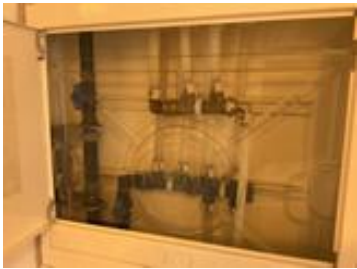
Fordelerskap rør i rør.
