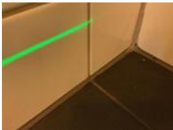
Oppsprekking silikonfuger i dusj.
