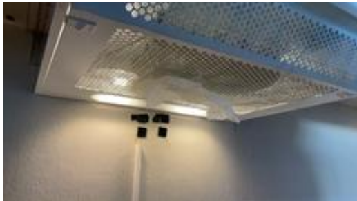
Ventilator funksjonstestet med papir.
