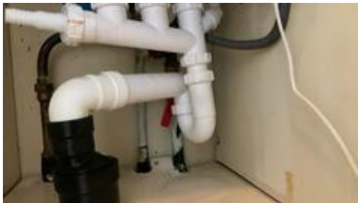
Stengekran på vann i benkeskap på kjøkken.
