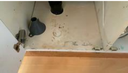
Fuktskader/merker i benkeskap/bunn.
