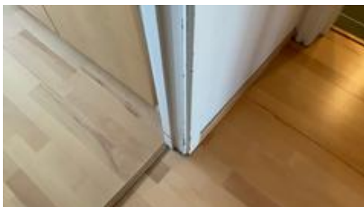
Bruksslitasjer/merker på karm/listverk og dører.
