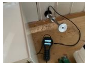
Måling med pigger i trevirke viser akseptabelt nivå.
