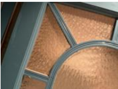
Sprukken glassrute i entredøren
