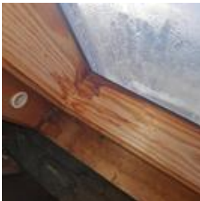
Spor etter kondens på nedre kant av takvindu
