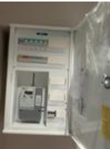
Sikringsskap med automatsikringer og kursfortegnelse
