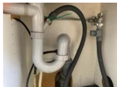
Røropplegg i skap under vask
