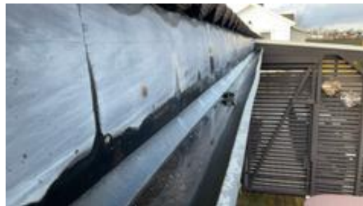
Vannansamling i takrenne.
