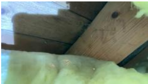
Synlige sperr og undertak, ingen lufting av skråtakskonstruksjonen.
