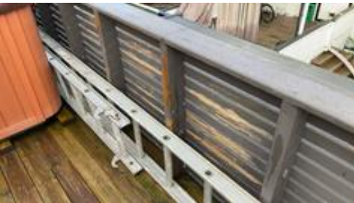
Værslitt/malingsavflassing på overflater i tre.
