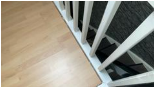
Mangel av list/fug mot rekkverk på trapp.
