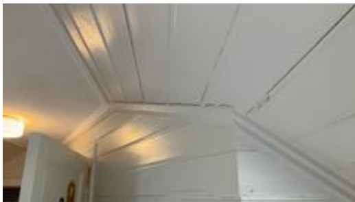
Sprikker i mykfuger/overflater loft.
