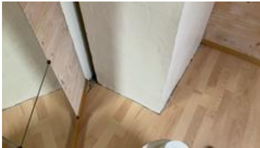
Uferdig rundt pipe på loft.
