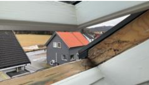
Værslitasjer/fukt i ramme på overlysvindu.
