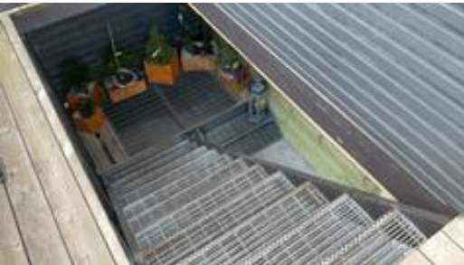
Ingen rekkverk/fallsikring på felles trapp ute.
