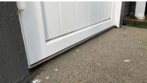
Ikke fagmessig løsning under terskel på balkongdører.
