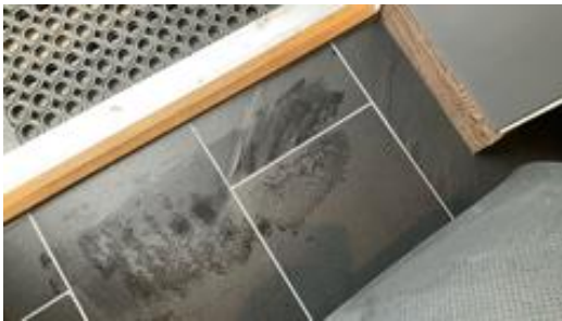
Sprikk i flis, bom/hullyd under.
