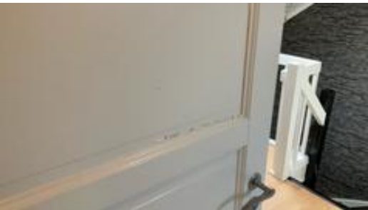
Sprikk i maling/fug i fyllinger.
