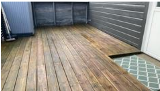
Skjevheter på overflater/terrassebord.
