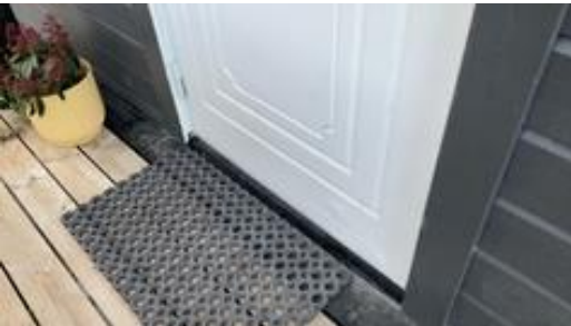
Fuktskader/svelling i nedre kant dørblad hovedytterdør.
