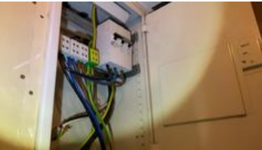
Felles el skap i tak entre.
