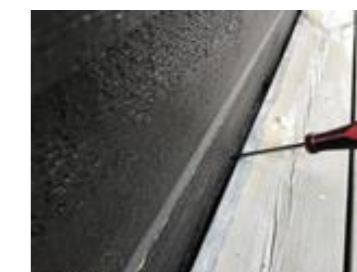
Påbegynnede råteskader bunn kledningsbord
