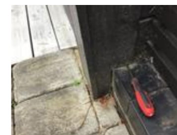
Påbegynnede råteskader bunn hjørnebord
