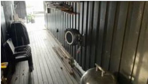
Utvendig spylekran på yttervegg i svalgang.
