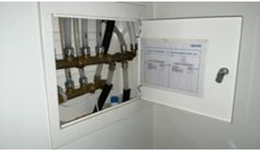
Røri rør vannfordeling til tappesteder.
