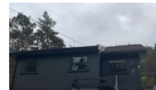
Det er ikke montert snøfangere på tak.
