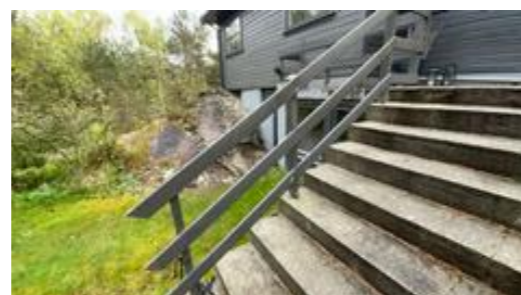
Rekkverk på utvendig trapp tilfredsstillende ikke krav i dagens forskrifter.
