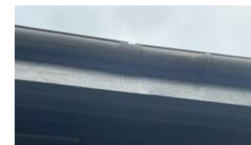
Det var på befaringdagen punktvis lekkasjer fra skjøter til takrenner.
