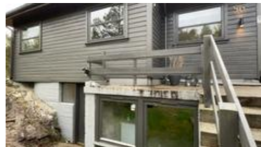
Rekkverk på terrasse tilfredsstillende ikke krav i dagens forskrifter.
