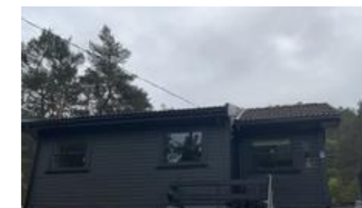
Det er ikke montert snøfangere på tak.
