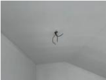
Løse ledninger i taket.
