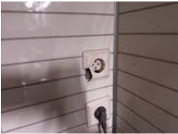
Ødelagt stikkontakt på bad
