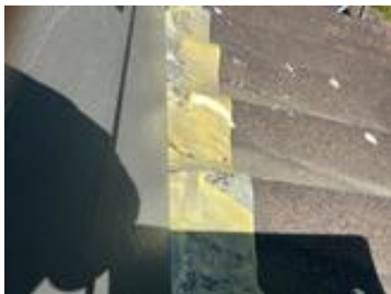
Blybeslaget sprekker opp.
