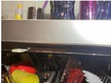
Svelling i benkeplate.
