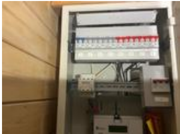
Sikringsskap med automatsikringer. Utleiedel.
