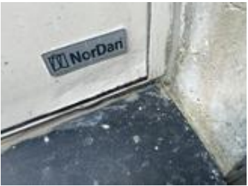
Slitasje på kjellerdør, dørblad.
