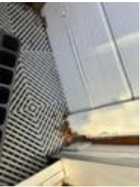
Påbegynnende råteskader bunn belistnings bord
