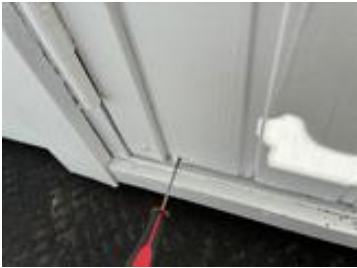
Påbegynnende råteskader balkongdør
