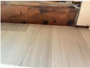
Fuktskjolder bunn svill balkongdør
