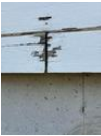
Værslitt kledning/påbegynnende råteskader
