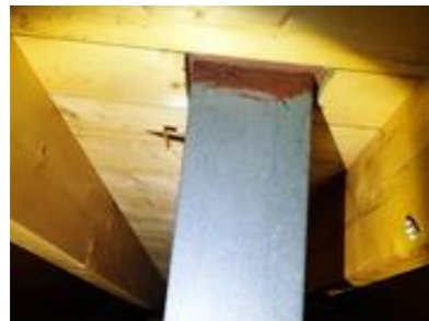
Ventilasjonrør mangler isolering.
