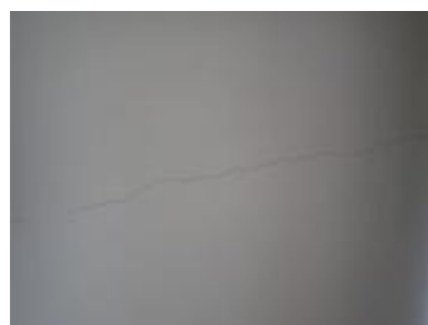
Eksempel på riss/ sprekk i grunnmur på soverom.
