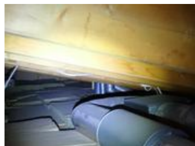
Det registreres manglende isolasjon på flere ventilasjonrør som går opp til tak.
