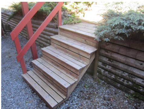
Rekkverk berre på ei side.
