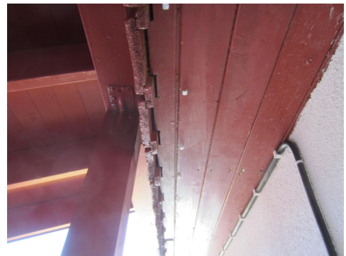
Lufting i nedkant er dels tetta.
