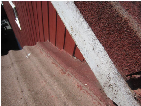
Overgang tak-vegg er utført utan fullgod beslag løysing.
