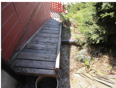
Rekkverk/håndløpar er ikkje montert
