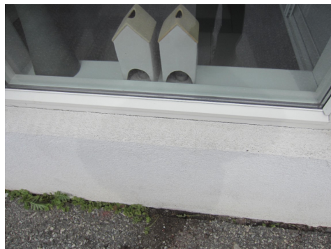
Vinduskarm er montert utan solebenk i nedkant.
