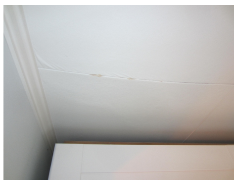
Mindre skade i himling etter tidl. lekkasje
