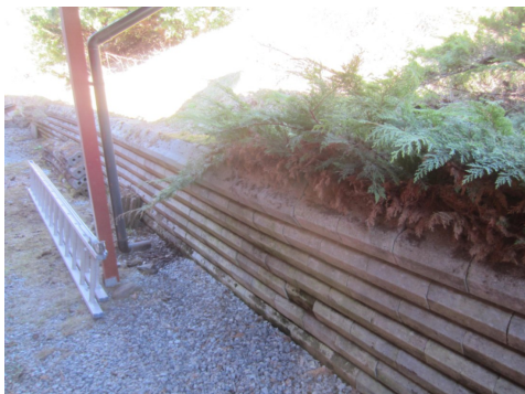
Bakkamur bak huset som hellar
