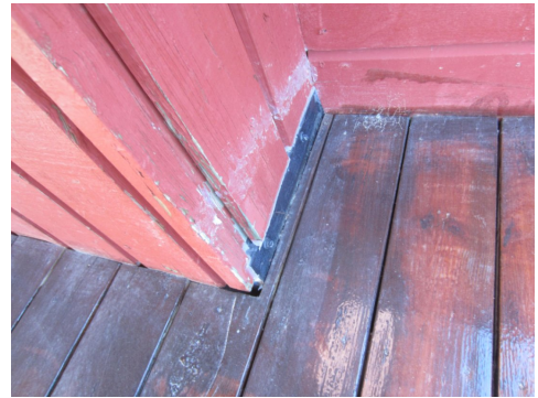
Ikkje kalring mellom altandekka og veggkledning.
