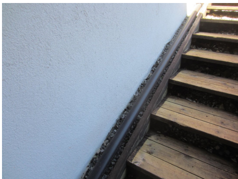
Rekkverk/håndløpar er ikkje montert
