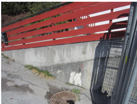
Døme på betongmur som er skada
