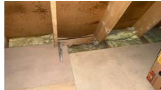
Det er mangler ved brannskille mot nabo. Observert fra loft over utvendig bod.
