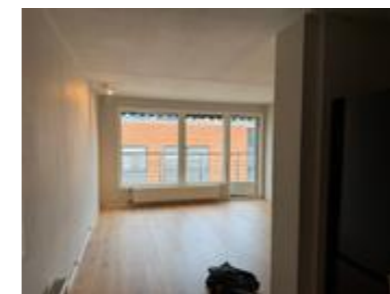
Skjevhet i gulv
