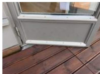
Balkongdør subber i gulvet
