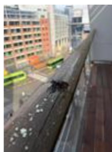
Råte i håndløper på balkongen.
