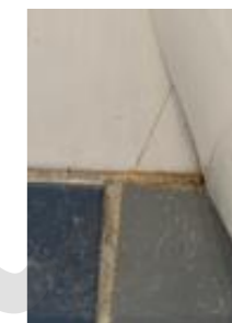
Sprekk i en veggflis under wc.
