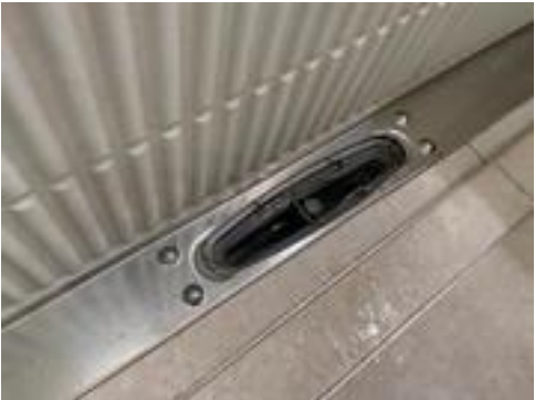
Slukrenne i dusjen. Slukmansjett og klemring.
