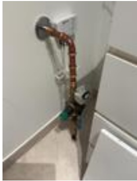
Stoppekran og reduksjonsventil for vann
