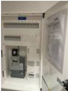
Sikringsskap med automatsikringer og kursfortegnelse
