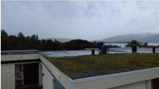
Del av taket over carporter og trafostasjon, med andre eiere, er mosegrodd og har rustne beslag
