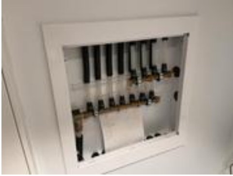
Fordelingsskap for tappevann
