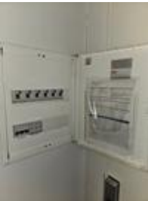
Sikringsskap med automatsikringer og kursfortegnelse
