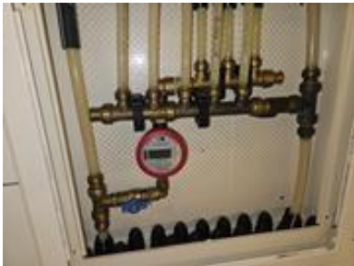
Fordelingskap for tappevann
