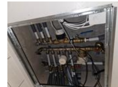
Luke i himlingen på badet mot fordeling for både tappevann og vannbåren varme. Stoppekraner for vann.
