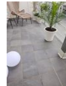
Flislagt veranda. litt bom under enkelte fliser
