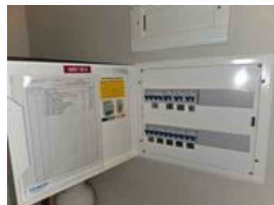
Sikringsskap med automatsikringer og kursfortegnelse
