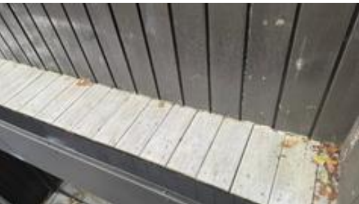
Balkong med fliser oppå balkongtekkingen.
