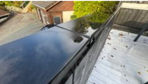
Rekkverk med laskeskjøter er ikke anbefalt av SINTEF/Byggforsk.
