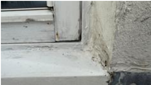
Fugemasse utenpå skal ikke være en del av tetting i overganger.
