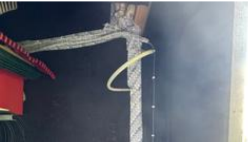
Uisolert vannledning i bod.
