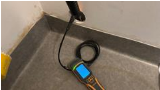
Hulltaking jf § 2-15 og måling i vegg mot grunnmur som befinner seg under terreng. Måleresultat er 10,9 vekt% og grønt på skalaen.
