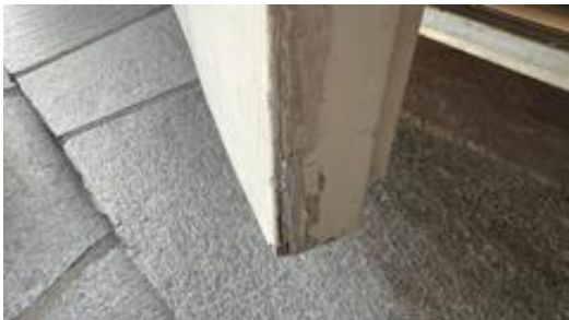
Entredør må ettersees over tid for ,ulig påbegynt delamineringer i dørblad.
