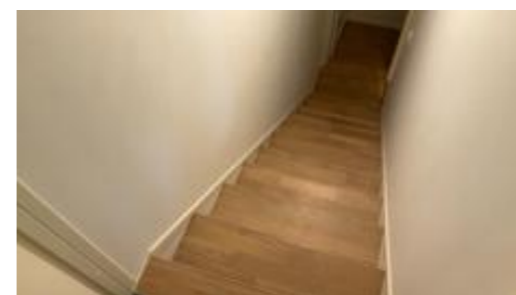
Innvendig trapp uten håndrekker på vegg.
