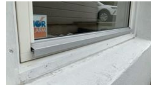
Ufagmessig belistning under vindu.
