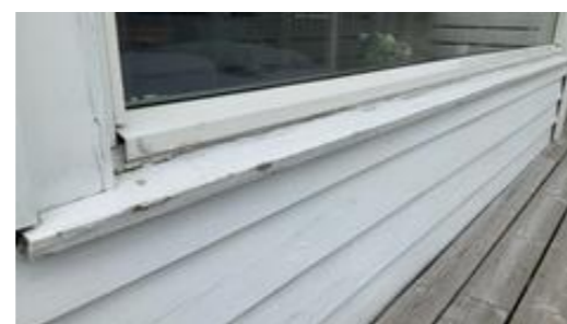
Oppsprikning/avflassing på enkelte vinduer.
