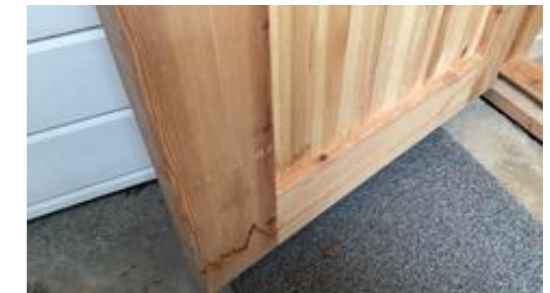
Kjellerytterdør/dørblad trekker opp fukt.
