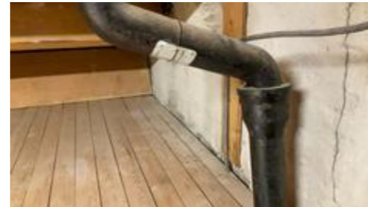
Lufting av avløpet over tak
