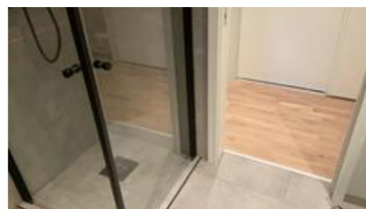
Dør plassert i dusjens fuktzone.
