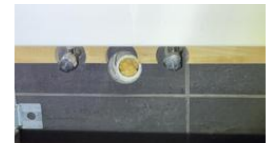
Ikke fuktrette rørgjennomføringer i vegg under vask.
