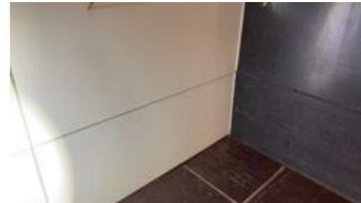
Kanting mellom fliser/ufagmessig utførelse.
