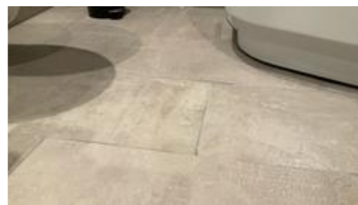
Kanting/bom under fliser på gulv.
