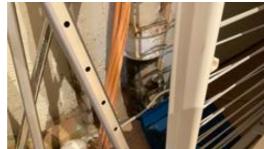
Stakemulighet på avløpsanlegget
