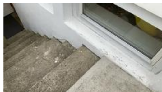
Malingsavflassing på deler av mur.
