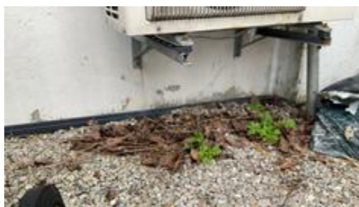
Malingsavflassing på deler av mur.
