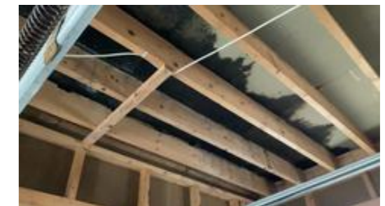
Lekkasjer fra teking sett i garasje.
