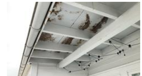
Lekkasje fra teking sett ved entre.
