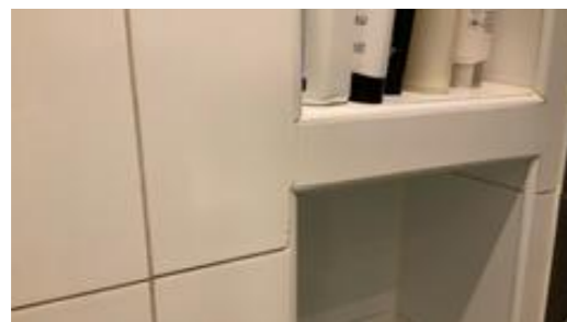
Sprikk i veggflis
