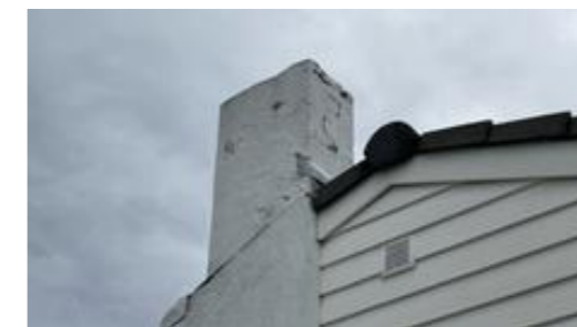
Riss/malingsavflassing på overflate pipe ute
