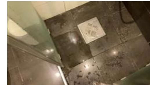
Vann vil ligge igjen på gulv/fliser i dusj etter bruk.
