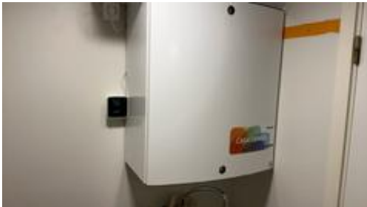
Balansert ventilasjon med styringspanel.
