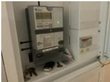
Sikringsskap med automatsikringer.
