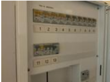
Sikringsskap med automatsikringer.
