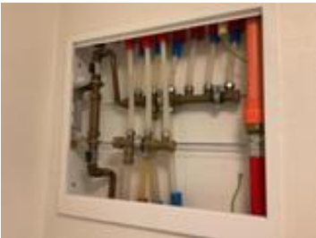
Fordelerskap rør i rør.
