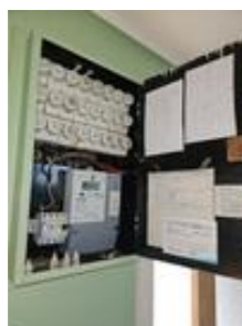
Sikringsskap med skrusikringer og kursfortegnelse
