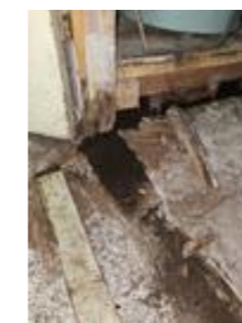
Fuktoppptrekk i innvendig delevegg av tre
