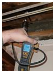
Ikke unormal fukt i undertaket her
