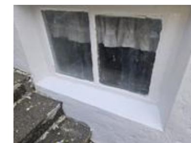
Kjellervindu med enkelt glass. Ikke beslag i underkant.
