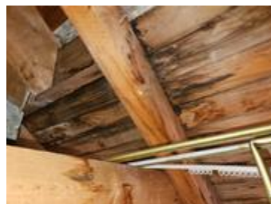
Fuktmerker og misfarging på deler av undertaket
