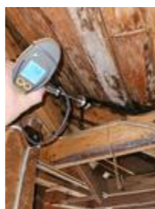
Litt høyt fuktinnhold i en takspærre
