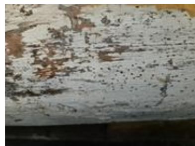
Hull i gulvbjelker etter borebiller, kjeller
