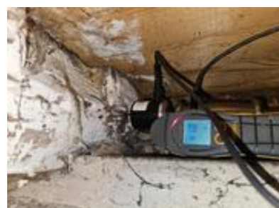
Høyt fuktinnhold i gulvbjelke mot kjeller
