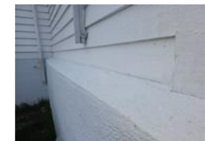
Det er ikke lufting langs nedre kant av bordkledningen
