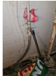
Stoppekran for vann i kjelleren
