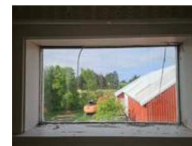
Utetthet mellom karm og glassrute, vindu i 2 etg sør
