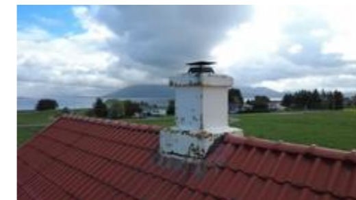
Pussede og malte piper over tak. Indikasjon på utetthet mellom piper og tekking
