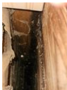
Bilde tatt fra loft, ned i yttervegg sør. Misfarget på baksiden av kledningen og delvis på bindingsverket. Ikke mulig å se helt ned til bunnsvillen
