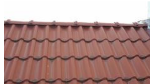
Begynnende rustdannelse på tekkingen
