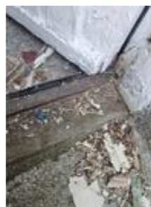
Viser terskel og nedre kant av kjellerdøren. Antydning til utflygingshull fra borebiller
