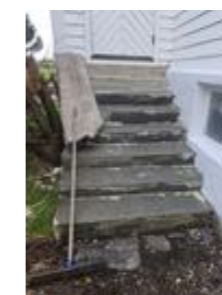
Trapp av betong til bakdøren
