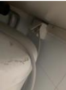
Tanken er koblet til stikkontakt
