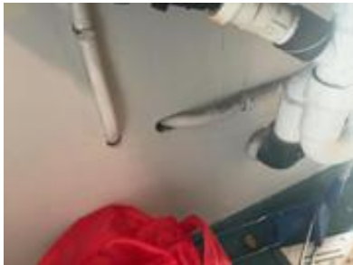
Utettheter i veggen under utslagsvasken, i våt sone
