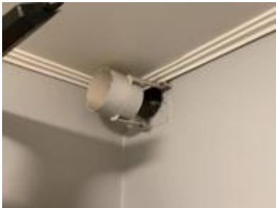
Luftventil på vaskerommet
