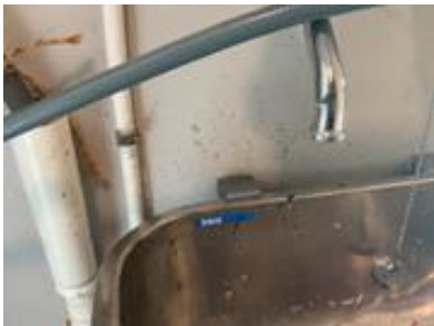
Flekker og bruksmerker på veggene
