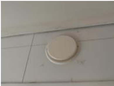
Ventiler med kanal over tak
