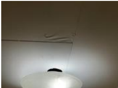
Skade på overflate på himlingsplate, gang
