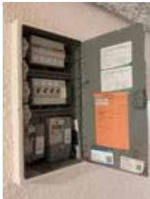
Sikringsskap med automatsikringer og kursfortegnelse
