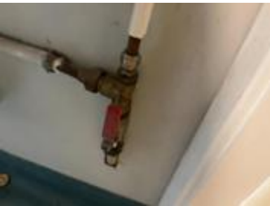
Stoppekran for vann, på vaskerommet
