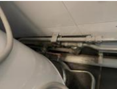
Stoppekran for vann, på badet
