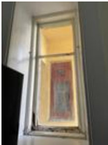
Gammel slitt kjøkkenvindu-moden for utskiftning
